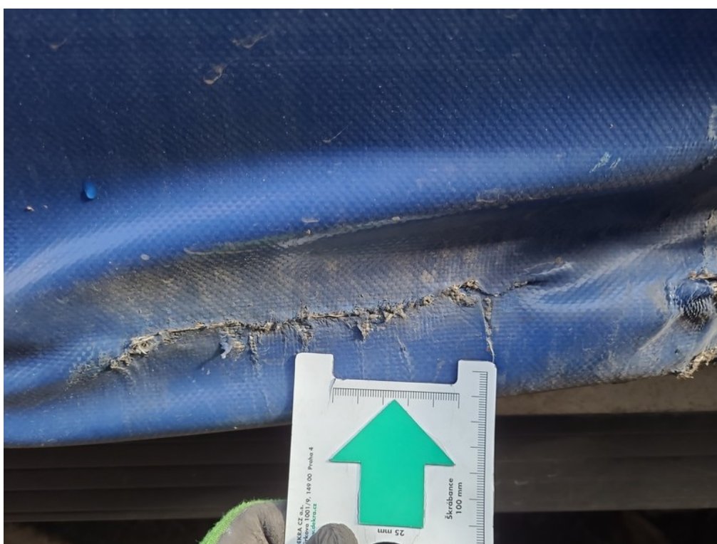
Viz popis k poškození č. 1
